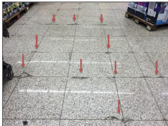
Figura 6 - Piso quebradiço nas proximidades das juntas de assentamento Fonte: Autoria própria (2016)
