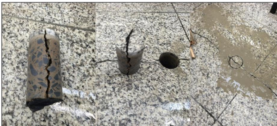
Figura 11 – Insuficiência de juntas estruturais Fonte: Autoria própria (2016)
