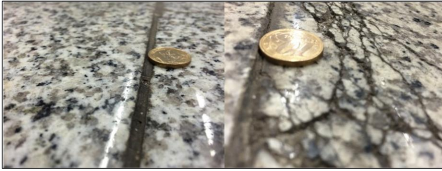
Figura 9 – Desnivelamento no assentamento do piso Fonte: Autoria própria (2016)
