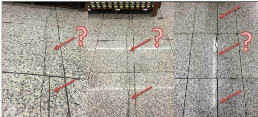
Figura 10 – Ausência da continuidade de juntas Fonte: Autoria própria (2016)
