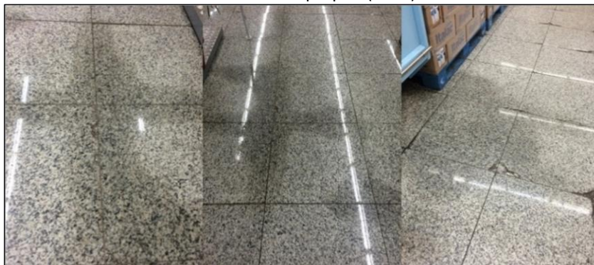
Figura 7 – Infiltração de água – eflorescência no granito Fonte: Autoria própria (2016)
